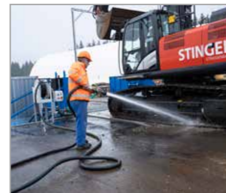
Afterwashing in the exit area Lavado posterior en la zona de salida
