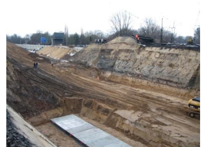
Nach Abtrag des Dammes, Erstellung der Fundamente für den Einschub der Brücke.
